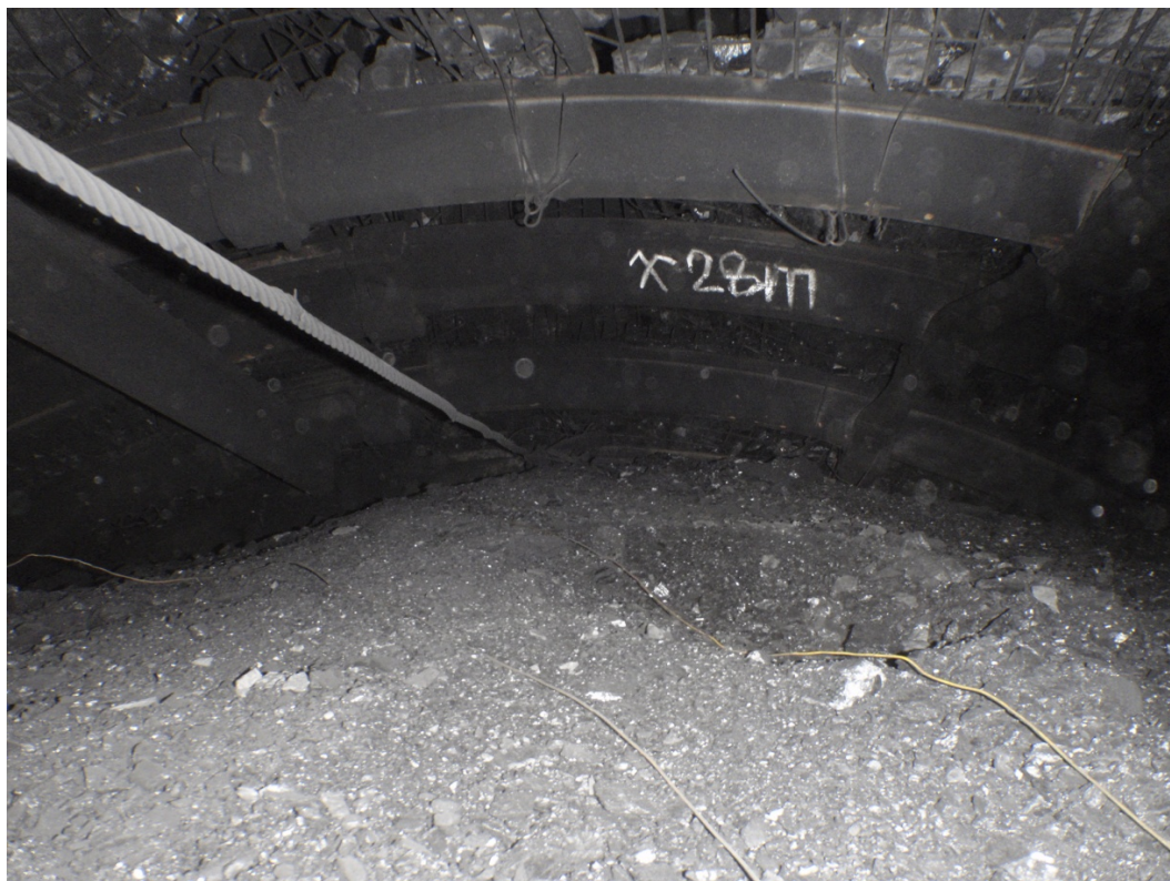
Obrázek 2 – Pohled na zakončení svahu výhozu na třídě 112 7453
