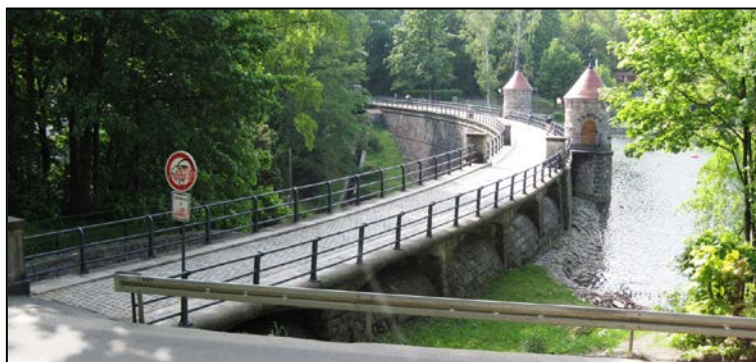
Obr. 2: Foto bezpečnostního přelivu, přehrady a přístupových věží k uzávěrům spodních výpustí na VD Harcov
